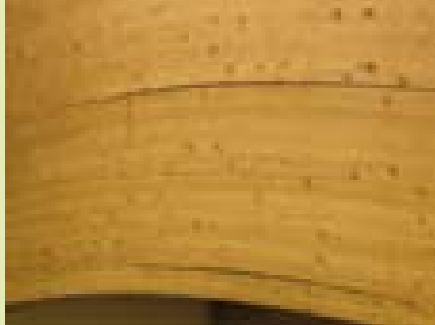
Mit diesen Rissen in den Bindern hätten wir die Halle nicht mehr lange betreiben dürfen. Mittlerweile ist eine Reparatur erfolgt.
